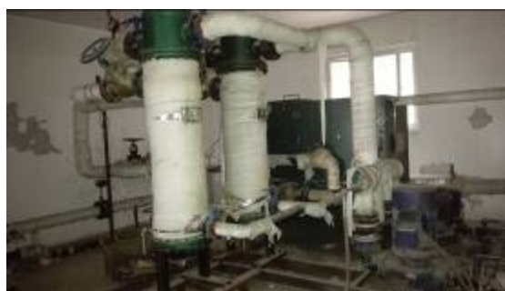
孙村中学换热站内部现状
