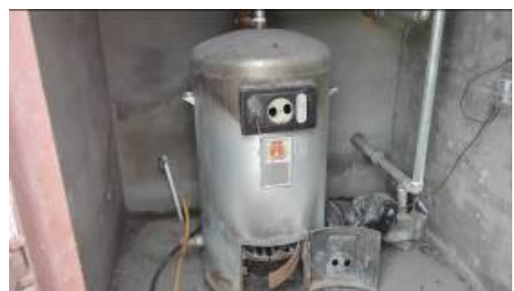
前管营分园锅炉房内部现状
